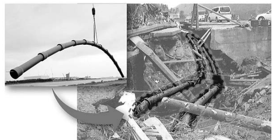
道路が崩落しても抜けなかった水道管
